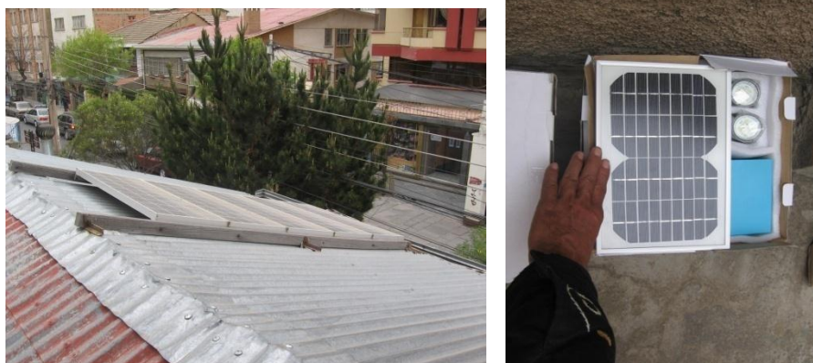
Foto 7. Paneles solares en el restaurante Armonía y en la casa particular del dueño del restaurante
