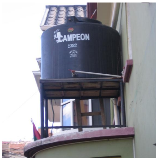
Foto 15. Tanque de almacenamiento de agua lluvias en el Restaurante y Librería Armonía
